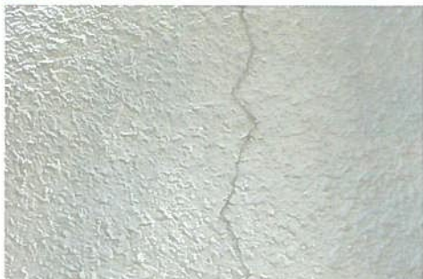
ひび割れ発生
