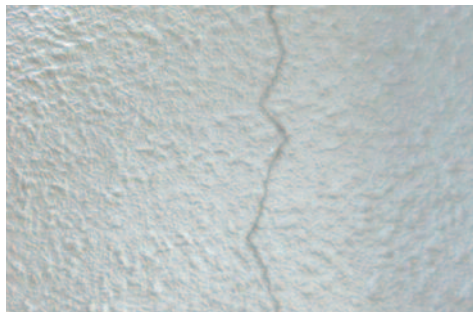
ひび割れ発生
